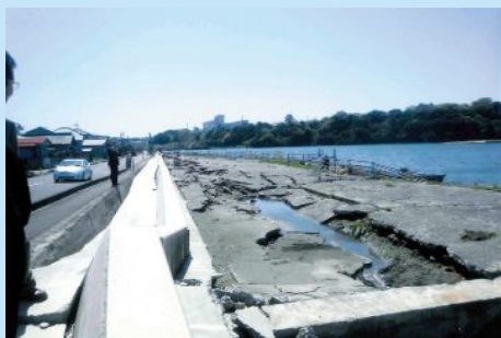
漁港の被災状況
